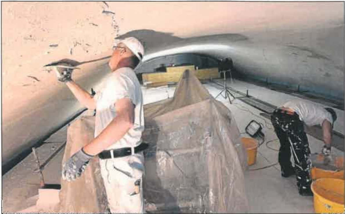
In der Schwefel Severin-Kirche laufen momentan unter der Decke die Putzarbeiten der Restaurierungsfirma „ars colendi“ an den Wand- und Gewölbeflächen. • Foto: Dahm
